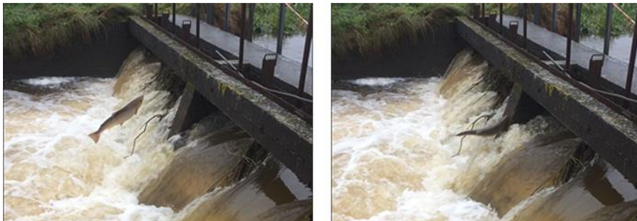
Figur 5: I Skjern Å ved tilløbet Rind Å (Skjern Å-forvirringen) forhindrer et stemmeværk, at laksene kan vandre frit op i Rind Å. Desuden får laksene skader, når de rammer betonfundamentet, som det sker på billedet til højre. Foto: Martin Skelmose.
